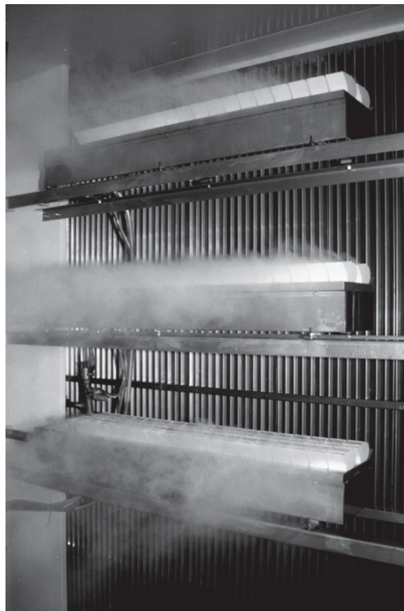
Abb. 23.8: Ultraschallbefeuchter in einer begehbaren Befeuchungskammer
