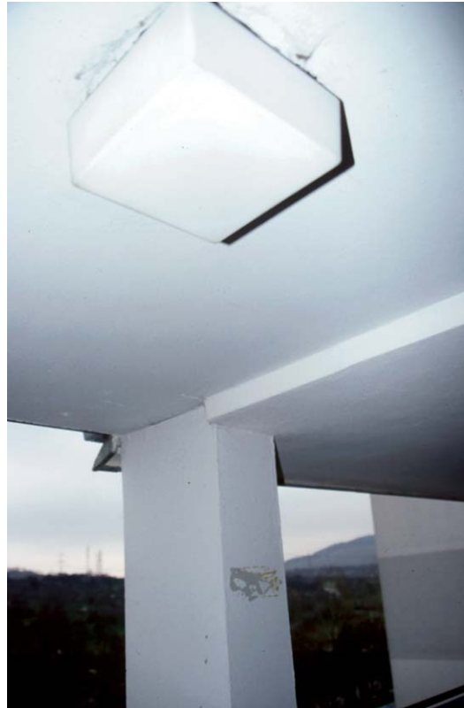
Abb. 10.4: Der Betonpfeiler weist eine Verbindung zur Außenwand aus Beton auf und stellt somit eine Wärmebrücke dar
