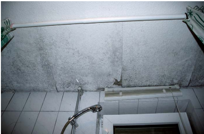
Abb. 10.6: Schimmelpilzbildungen an der Deckenunterseite einer Badezimmerdecke
