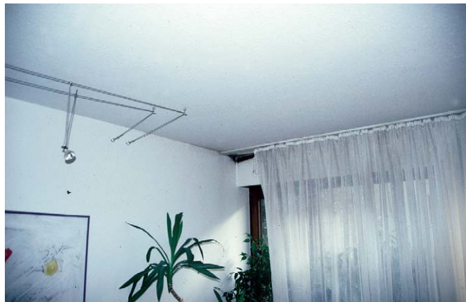
Abb. 10.2: Schimmelpilzbildungen in der Ecke unterhalb einer nach außen durchlaufenden Balkonplatte aus Beton
