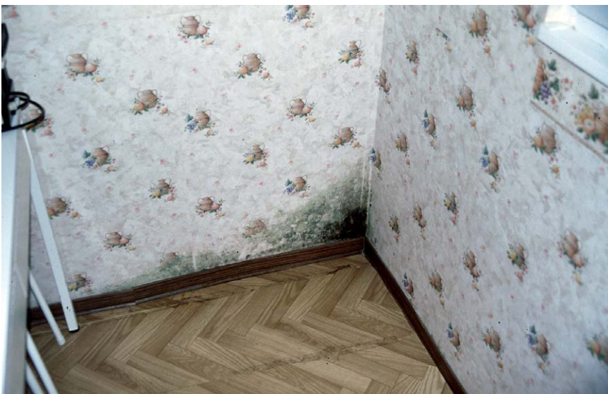
Abb. 10.3: Schimmelpilzbildungen in der Außenecke einer Küche oberhalb eines Betonpfeilers
