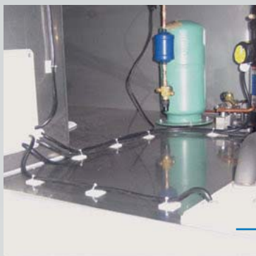
Hygienegerechte geräteinterne Verkabelung.
