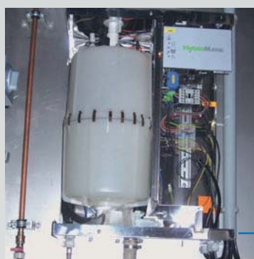
Elektrische Dampferzeuger im Maschinenteil installiert.
