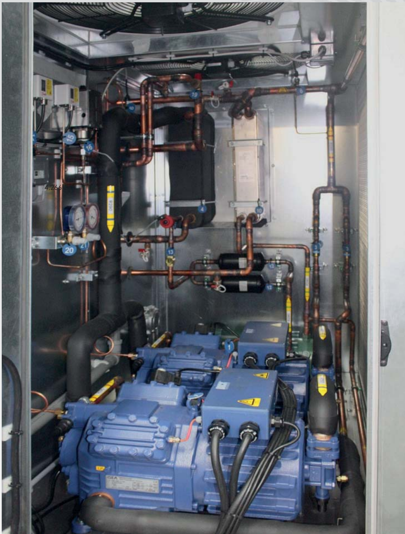
Bild 36: ATEX-Kälteanlage mit natürlichem Kältemittel R290
