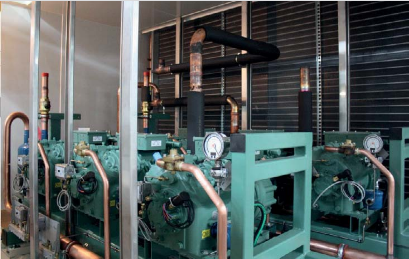
Bild 34: halbhermetische Verdichter im Verbund
