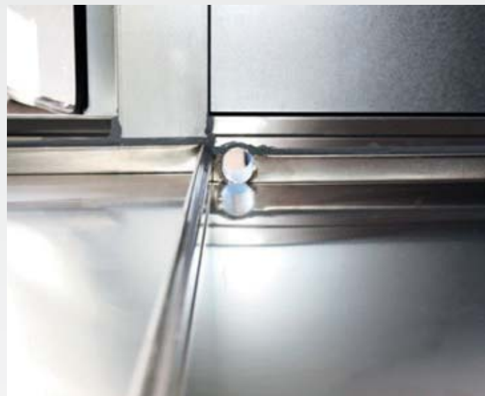
Bild 17: Kondensatablauf von innen
