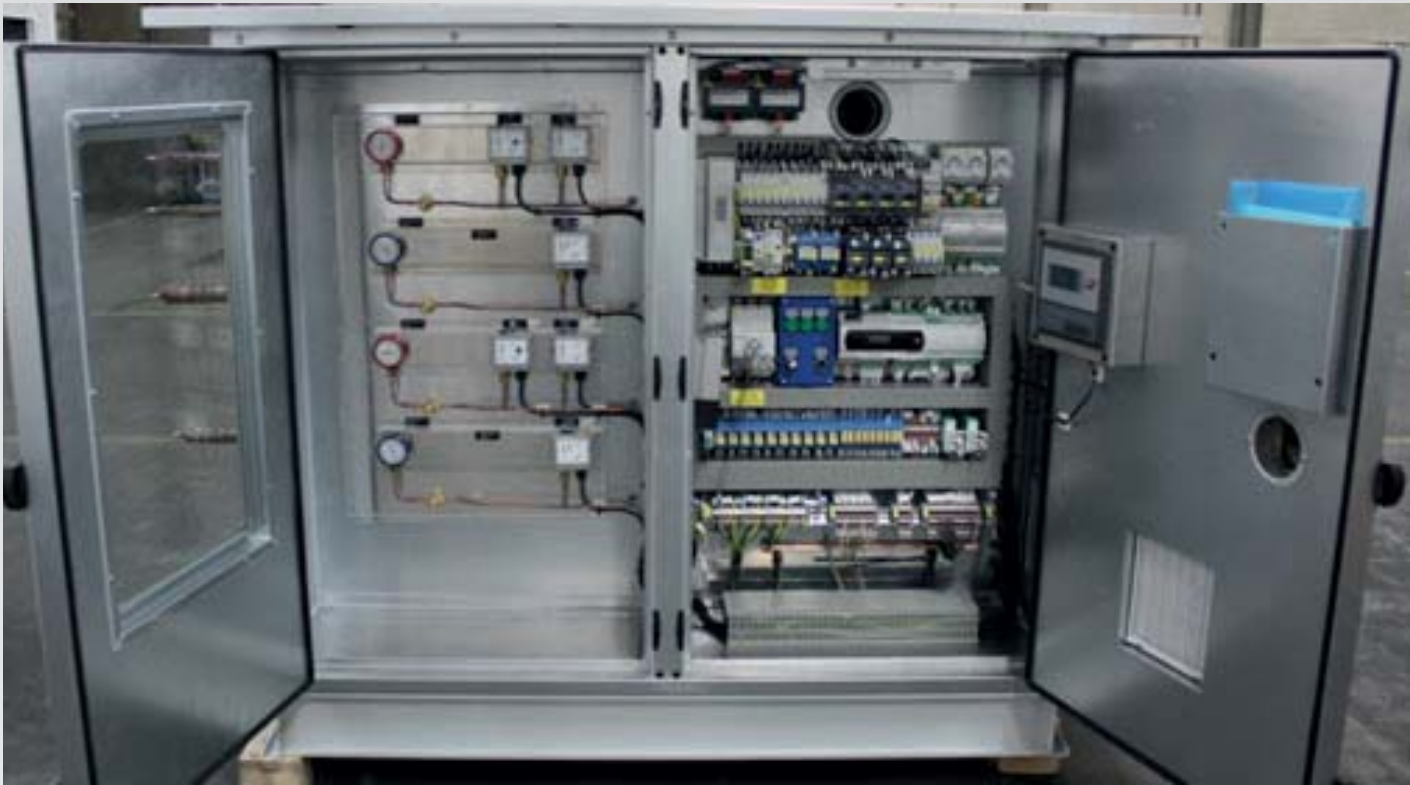
Bild 37: Abgeschottete Drucküberwachung mit großem Sichtfenster und Kälteregeleung
