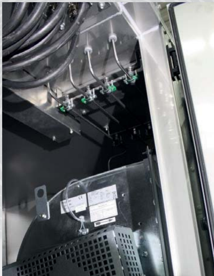
Bild 26: Luftleitungen zur Druckentnahme V2A
