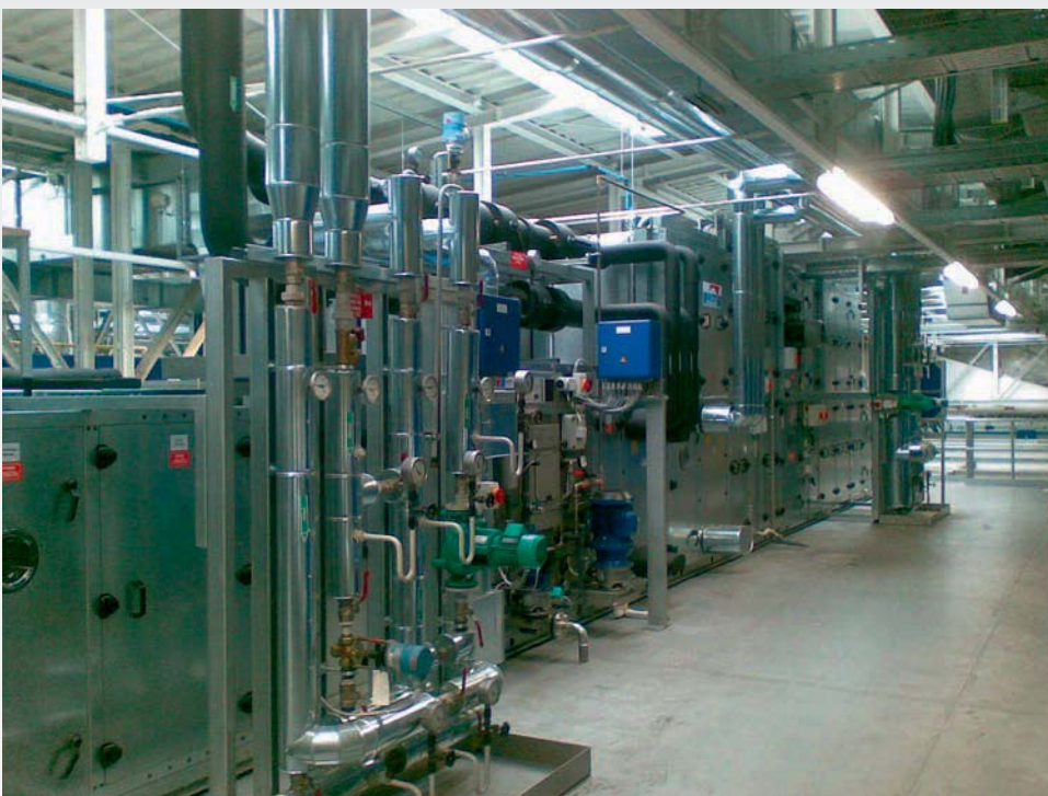
Regelgruppen für KV-System, Kalt- und Warmwasser, außen am Gerät installiert.
