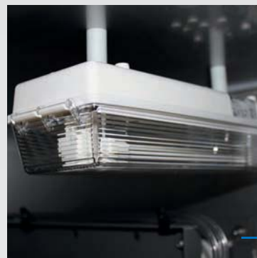
Leuchtstofflampe (IP65) zur besseren Reinigungsmöglichkeit auf Abstand montiert (VDI 6022-Zulassung).
