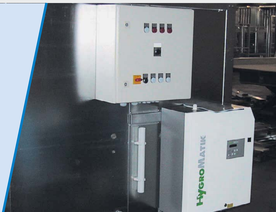
Elektrischer Dampferzeuger funktionsfertig außen am Gerät montiert.
