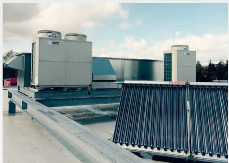
Kombination aus Luft-Luft-Wärmepumpe und Solarthermie.
