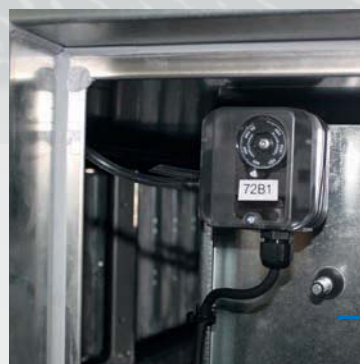
Druckschalter zur Filterüberwachung und Ventilatorenüberwachung.
