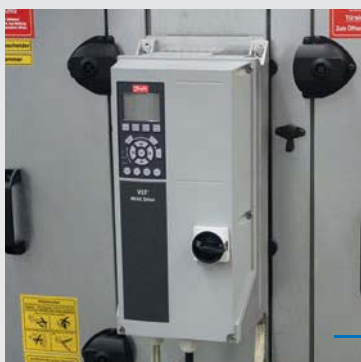
Frequenzumformer außen am Gerät montiert und verkabelt.
