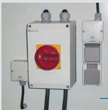
Wartungsschalter mit Verkabelung zur Motorklemmdose für Kaltleiter.
