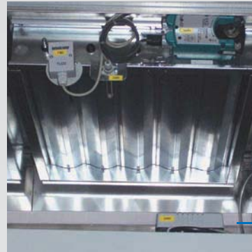
Feldgeräte für die Regelung funktionsfertig im Gerät installiert.
