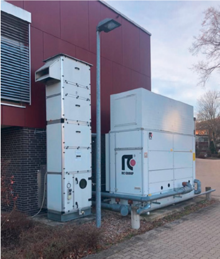
Abbildung 9: Lüftungsgerät zur Versorgung des Operationssaales
