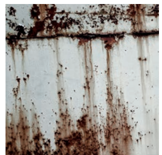
Vermeidung von Rost und Korrosion
