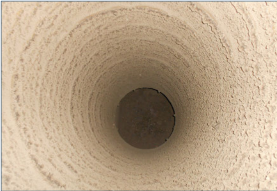
Innenansicht Kanal vor der Reinigung
