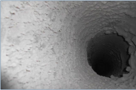
Innenansicht Kanal vor der Reinigung
