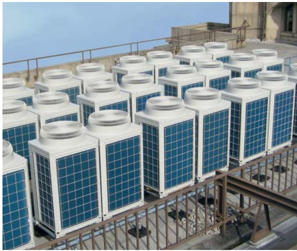
Bei größeren Projekten mit einem hohen Bedarf an thermischer Leistung werden oft sehr viele VRF-Außengeräte nebeneinander auf dem Gebäudedach aufgestellt. (Abb. Bigfoot)
